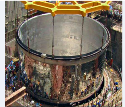
PFBR, 500 MW(e) India, 2024
