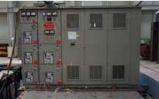
Rozdzielnica niskiego napięcia
